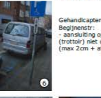
Begijnstr. NR 180: paaltje ontbreekt, stoeptegels liggen onregelmatig
